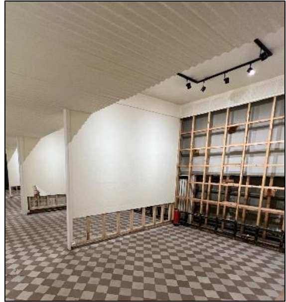
Figure 23 : Enlèvement des panneaux de cloisons qui ont été immergés dans l'eau – Musée des Beaux-Arts de la Céramique de Verviers (© Caroline Preser).
