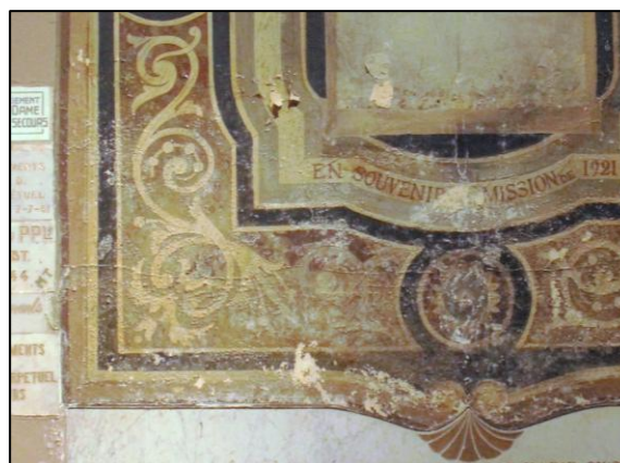
Figure 22 : Apparition d'efflorescences et de subflorescences dans les mois qui ont suivi l'inondation – Décors de fausse marqueterie de marbre dans l'église de la Visitation de la Vierge de Dolhain.
