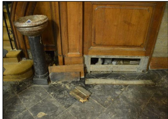
Figure 24 : Aération du lambris par dépose des plinthes – Église Notre-Dame des Récollets de Verviers.
